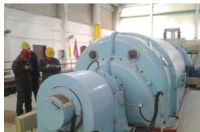
鞍钢集团鞍凌公司25兆瓦汽轮发电机组并网发电
